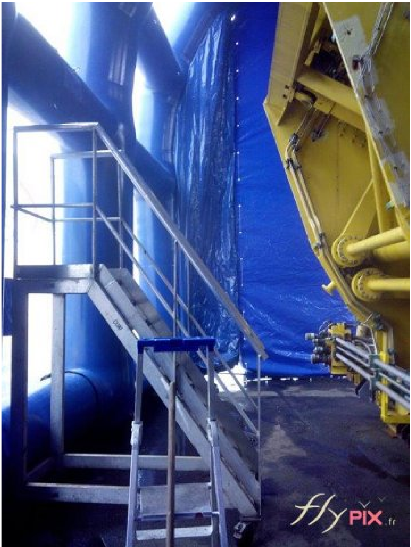
Plate forme avec une machine, à l'intérieure d'une tente gonflable industrielle.
